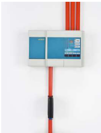
Figura 4 - Central de detecção por aspiração e módulo VESDA ECO NH3/H2.
