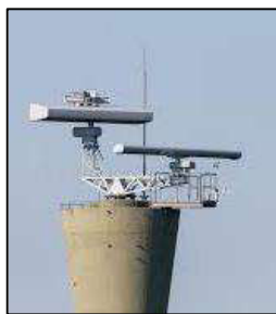
Figura 12. Exemplo de instalação de radares
