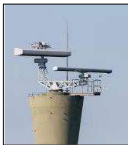
Figura 12. Exemplo de instalação de radares
