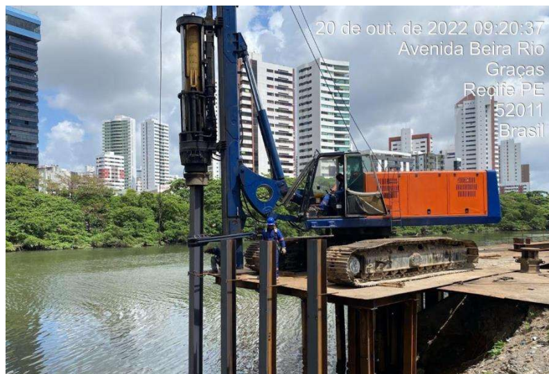
Figura 02 – CAT 2220569300/2023 - Cravação de estacas metálicas em água sobre plataforma em estrutura metálica
