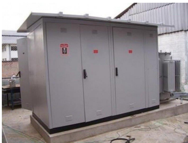
Exemplo de subestação blindada compacta unitária para uso ao tempo – Fonte: http://www.wtaengenhariaeletrica.com.br/instalacao-cabine-primaria
