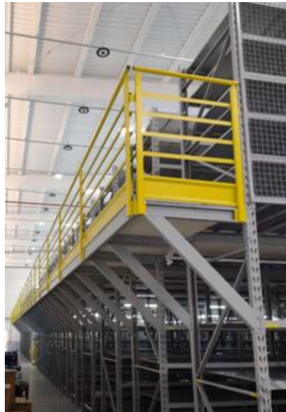
Figura 03 – Imagem ilustrativa de passarela frontal para acesso aos corredores do piso intermediário
