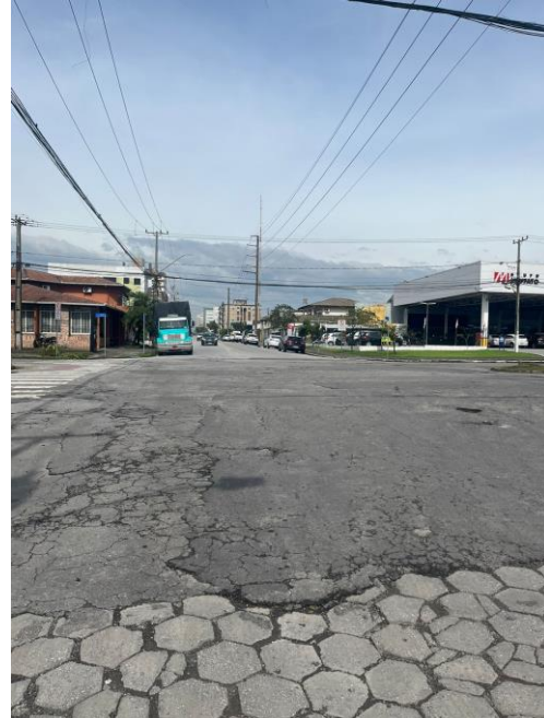
Figura 7: Condição atual do cruzamento da Rua Manoel Corrêa e Av. Cel José Lobo.
