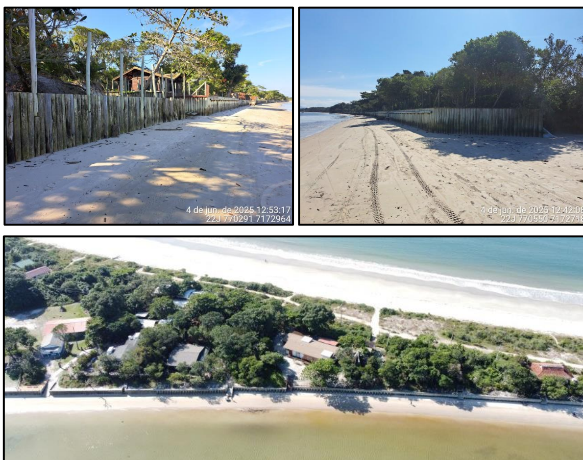
Figura 66 – Contenções de erosão costeira na parte norte do istmo da Ilha do Mel, na praia voltada para o continente.
