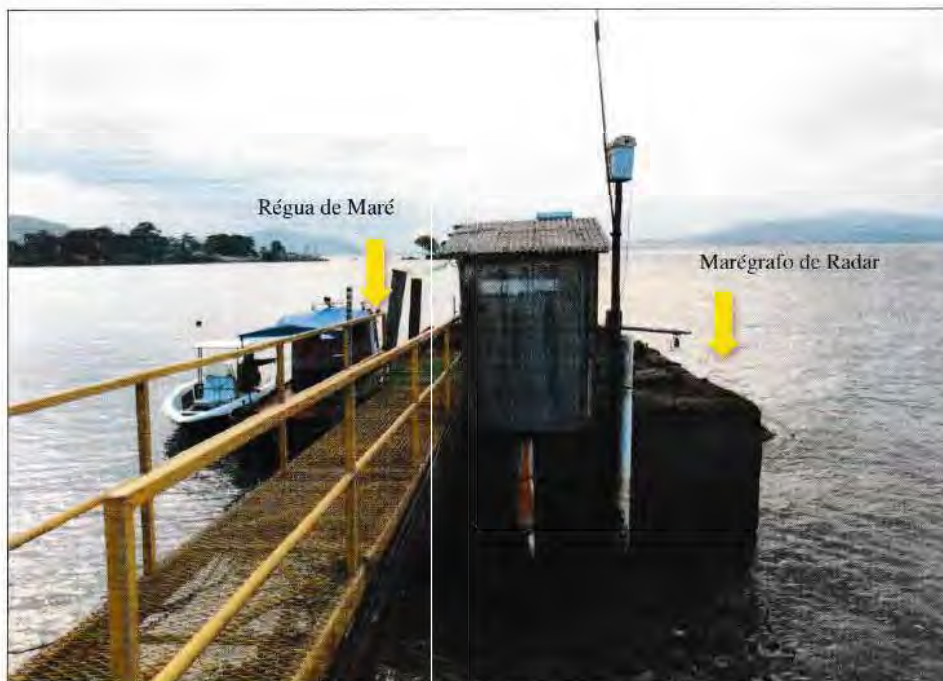
Figura 8: Layout da instalação do marégrafo de Radar Valeport VRS-20, em Ponta do Félix.
