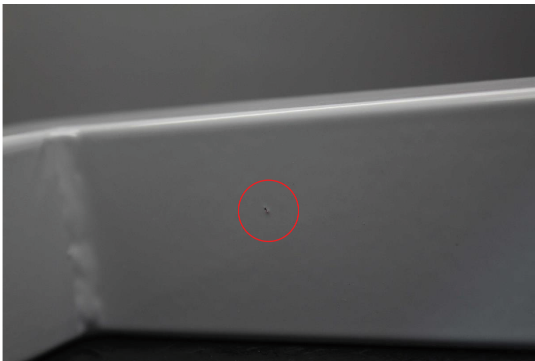
Amostras 1 após 672 horas. Ponto de corrosão vermelha que apareceu após uma bolha estourar.
