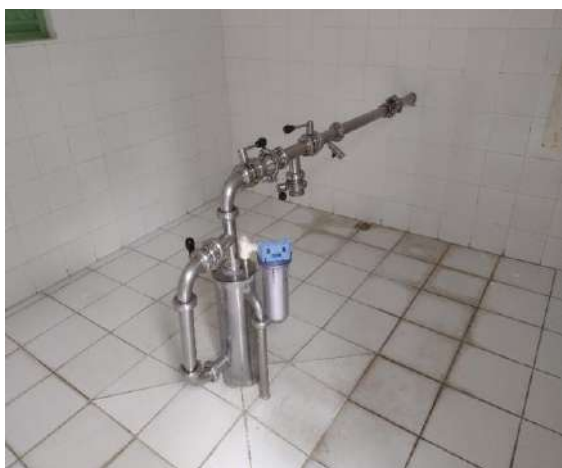
Captação do Poço
